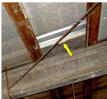
Obr. 15. Stopy po náraze tuhého predmetu do stropu
